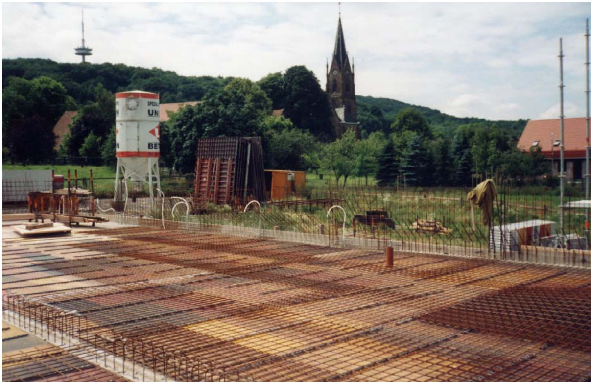
Blick auf das Fundament des Erweiterungsbaus in Richtung Lerbecker Kirche. Vor dem Silobehälter würden die zukünftigen Technikräume erdgeschossig liegen.
